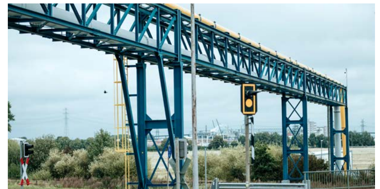
Vorhandene Infrastruktur im Hafen von Brunsbüttel, auch für den Import von LNG. Perspektivisch ist diese Infrastruktur technisch umzurüsten, um sie auch für den Export von CO 2 nutzen zu können.
