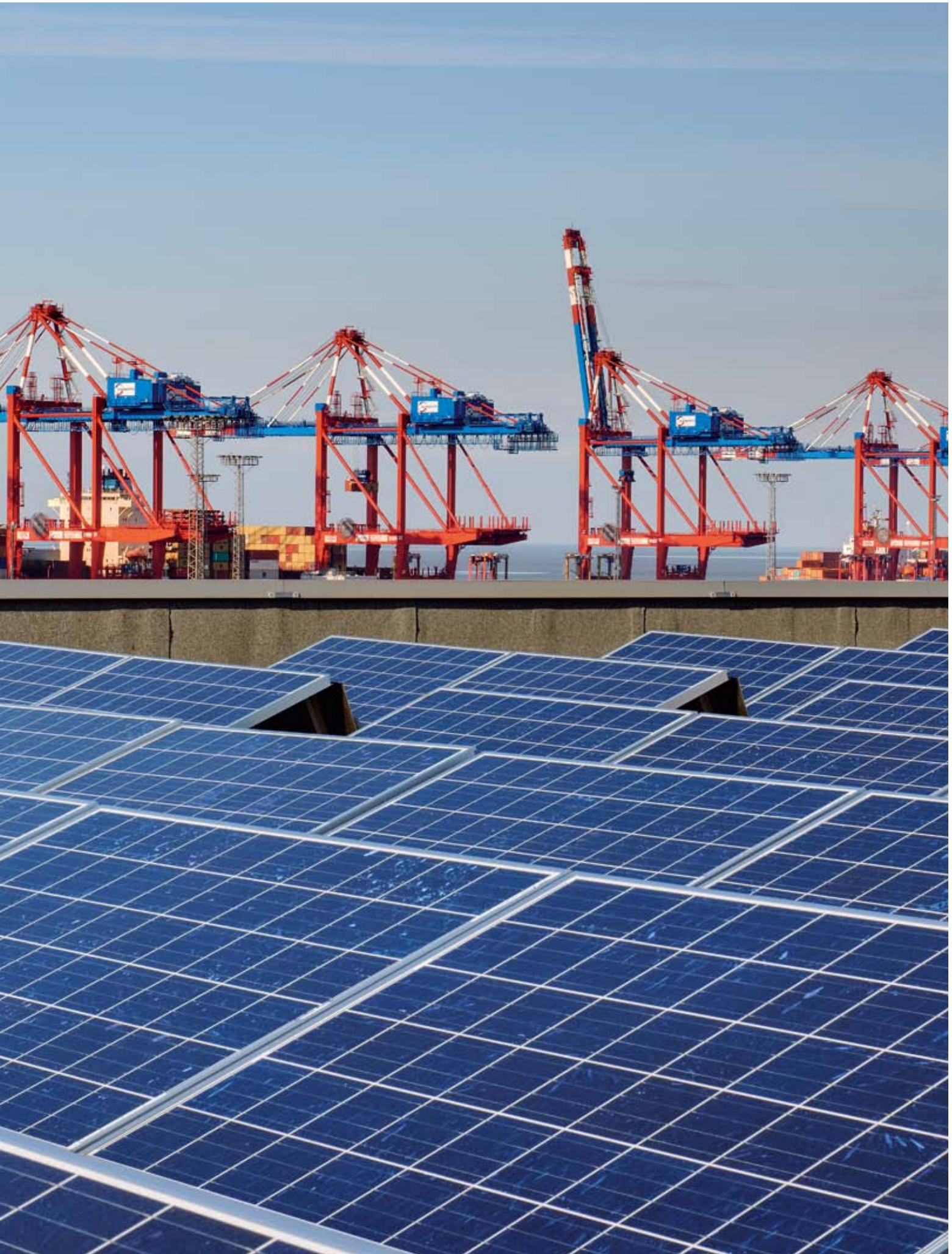
Solaranlage in Bremerhaven
